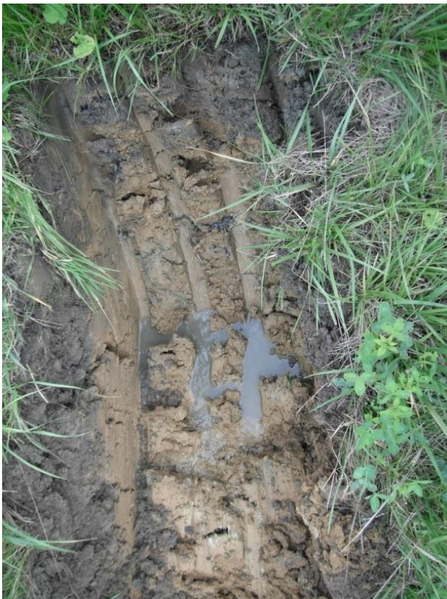
Silný výron vody ještě před dosažením ochranné vrstvy z ŠD.
