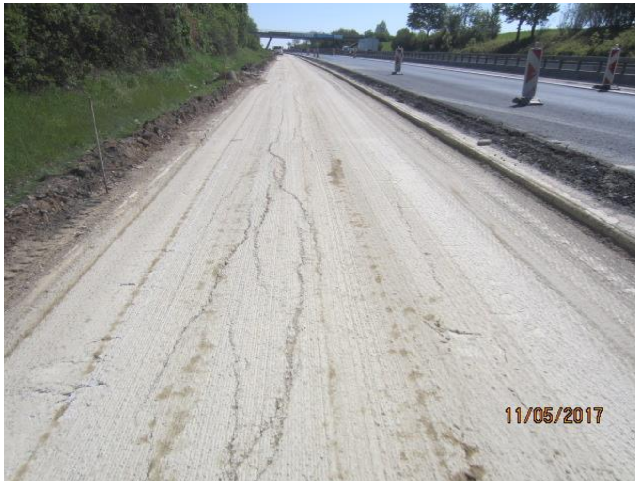
Povrch SC po odfrézování 120 mm – poruchy se zvětšují.
