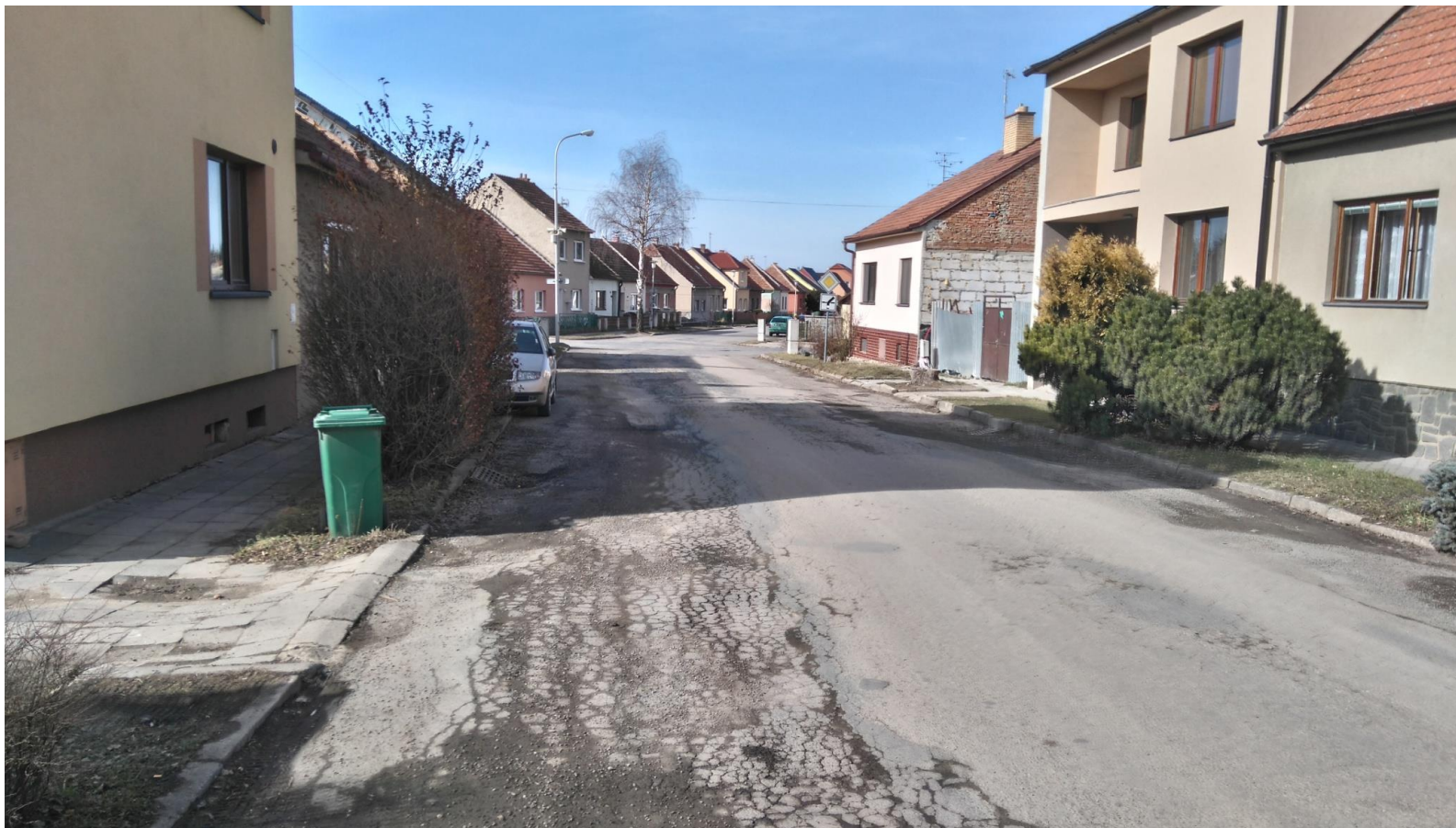
Stav komunikace před zahájením prací
