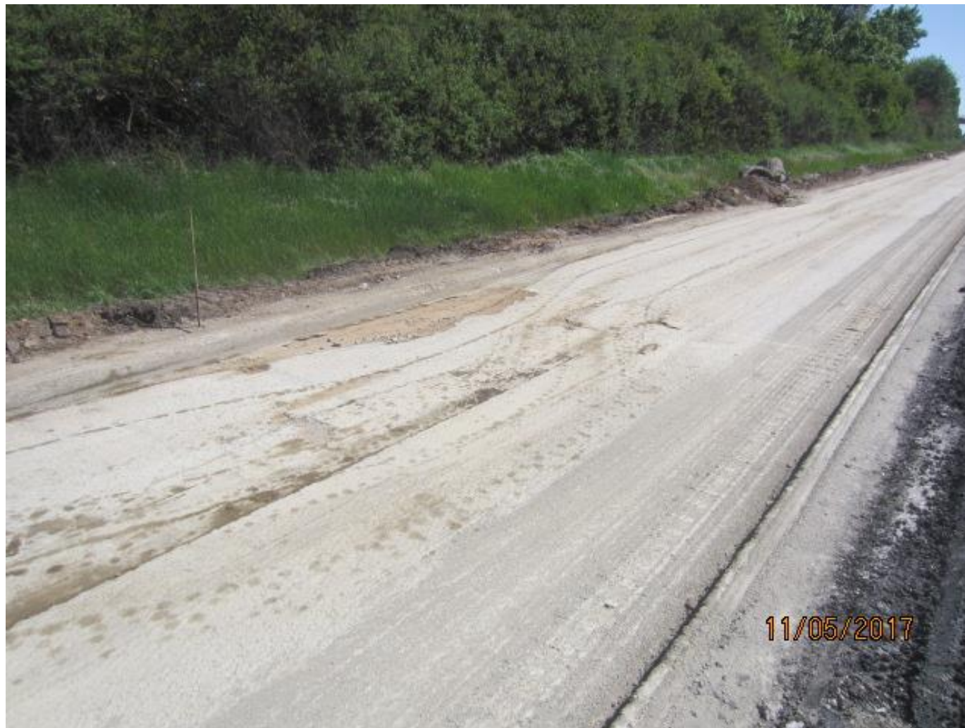
Po odfrézování 120 mm byla zjištěna nerovnoměrná tl. SC.
