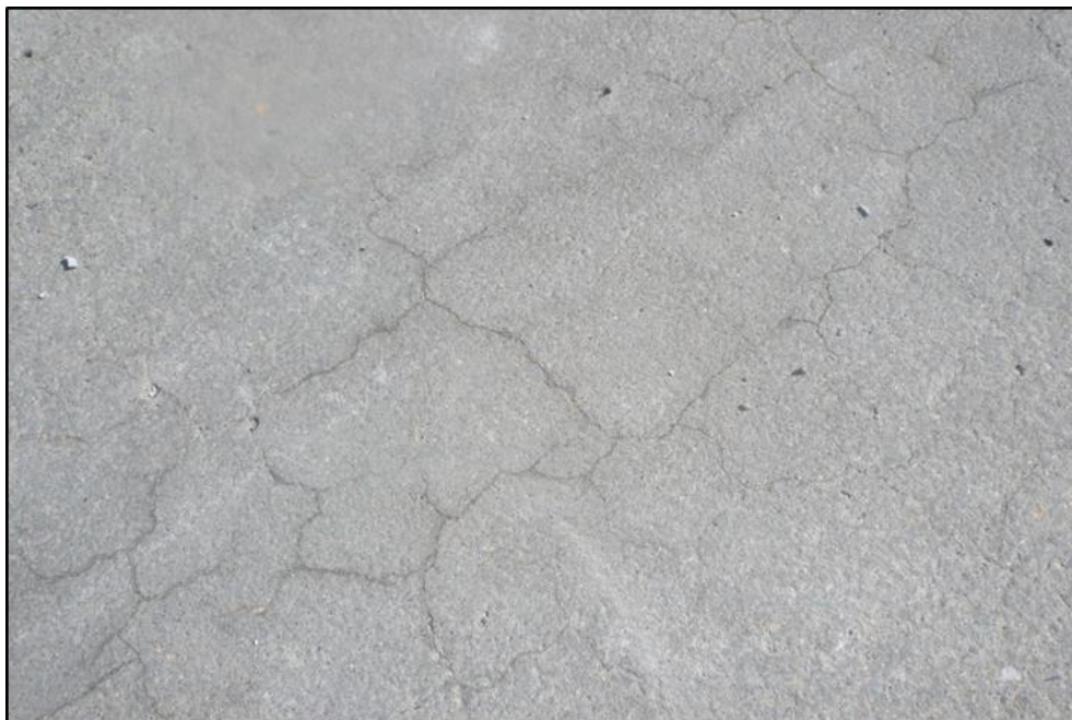
Obrázek 1: Porucha povrchu – mapové trhlinky (foto J. Havelka, 2020)
