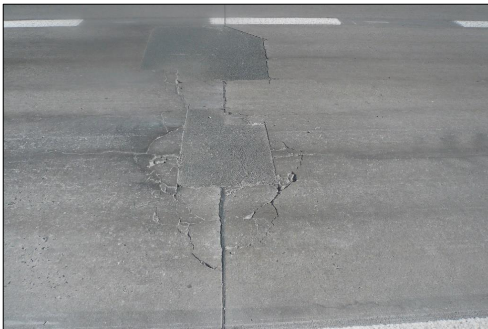
Obrázek 2: Porucha na spárách s destrukcí – ulomená hrana desek (foto J. Havelka, 2020)
