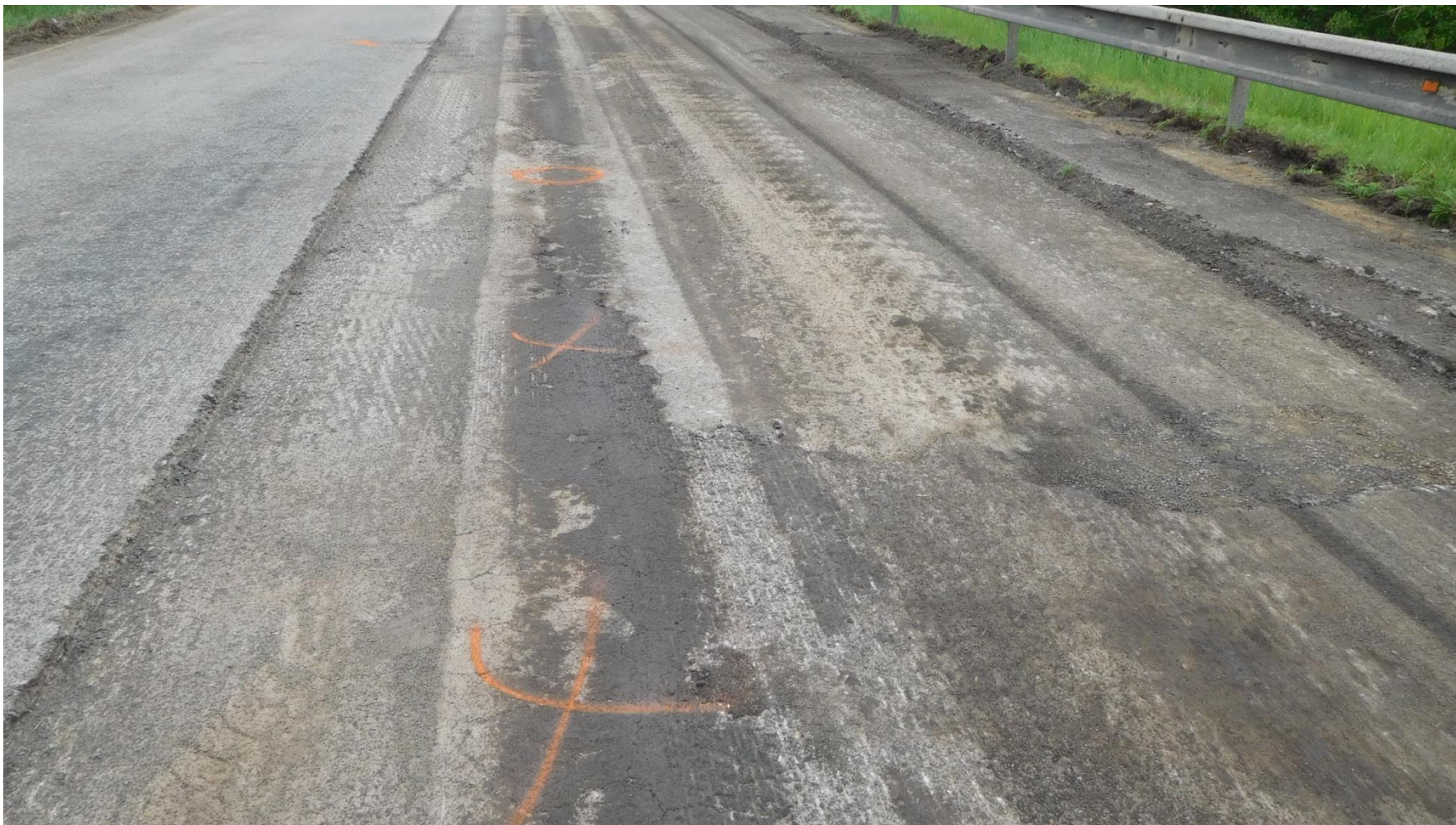
Místo č.2: Plocha po odfrézování 180 mm. Síťové trhliny v ploše pomalého jízdního pruhu s mozaikovými trhlinami v jízdních stopách.
