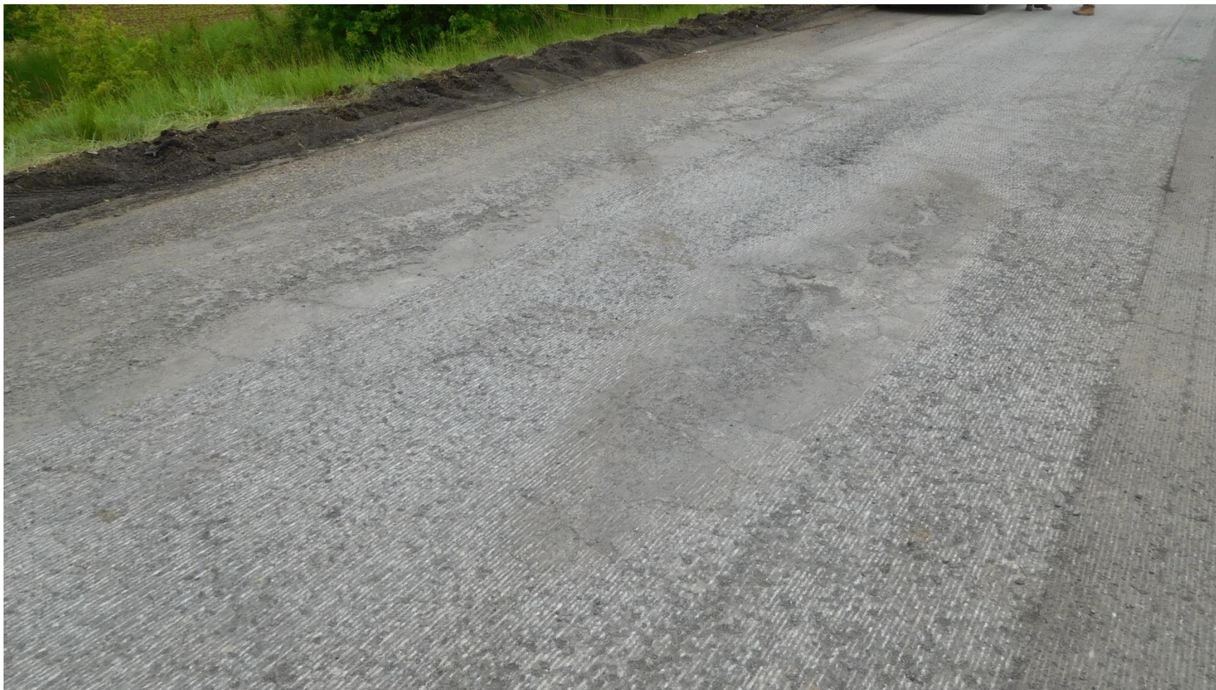
Místo č. 1: Stav povrchu po odfrézování 120 mm – síťové trhliny, vyjetá kolej s mozaikovými trhlinami.
